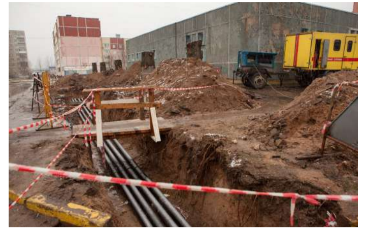
Ремонт горячего водо- и теплоснабжения бассейна «Дельфин» Детско-юношеской спортивной школы стал возможен благодаря финансовой поддержке Калининской АЭС
